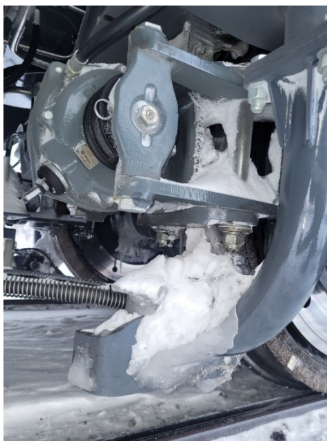
Obr. 4 Mechanická brzda lokomotivy
